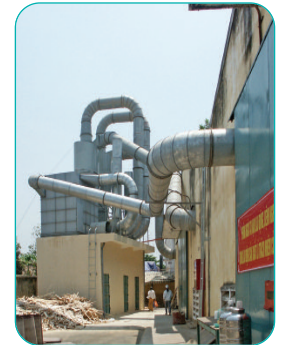
Dự án: Công ty TNL Địa chỉ: Tp. HCM Công việc: Hệ thống lọc bụi xưởng SX gỗ Công suất: 15.000 – 18.000m 3 /h
