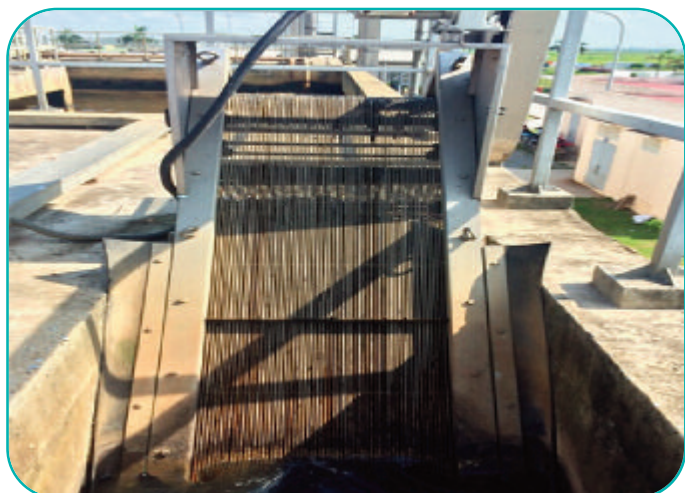
Tên dự án: Hệ thống thoát nước và xử lý nước thải - Dự án Phát triển toàn diện Kinh tế - Xã hội thành phố Thanh Hóa Địa chỉ: tỉnh Thanh Hóa. Công việc: Gia công lắp đặt hệ thống song chắn rác, máy cào rác
