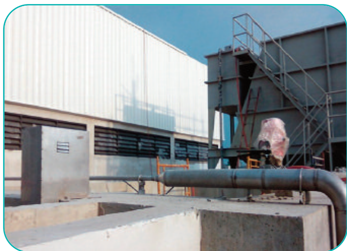
Tên dự án: Hệ thống xử lý nước thải Nhà máy NPK Quảng Bình Địa chỉ: Thủy Nguyên, Hải Phòng Công việc: Tư vấn thiết kế, Thi công lắp đặt hệ thống xử lý nước Công suất: 60m 3 /ngày
