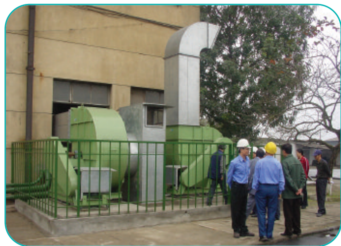
Dự án: Liên doanh SX ô tô VMC Địa chỉ: Thanh Xuân - Hà Nội Công việc: Hệ thống thông gió phân xưởng sơn
