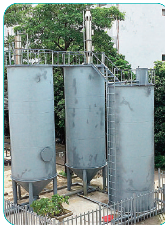
Tên dự án: Hệ thống xử lý nước ngầm Địa chỉ: Nguyễn Trãi, Thanh Xuân, Hà Nội Công việc: Lắp đặt hệ thống xử lý nước ngầm
