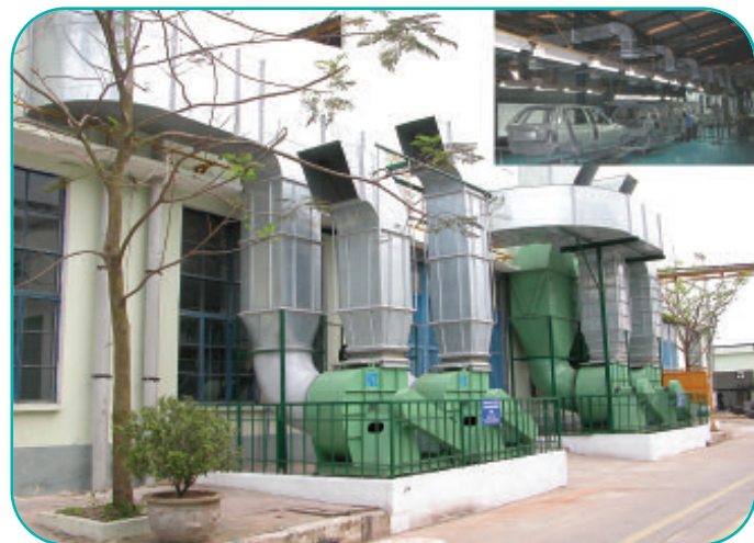
Dự án: Nhà máy nhiệt điện Ninh Bình Địa chỉ: Thành phố Ninh Bình Công việc: Hệ thống thông gió gian biến thế
