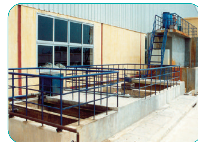
Tên dự án: Công ty Mô tô Việt Nam Địa chỉ: KCN Nội Bài - Hà Nội Công việc: Hệ thống xử lý nước thải bề mặt
