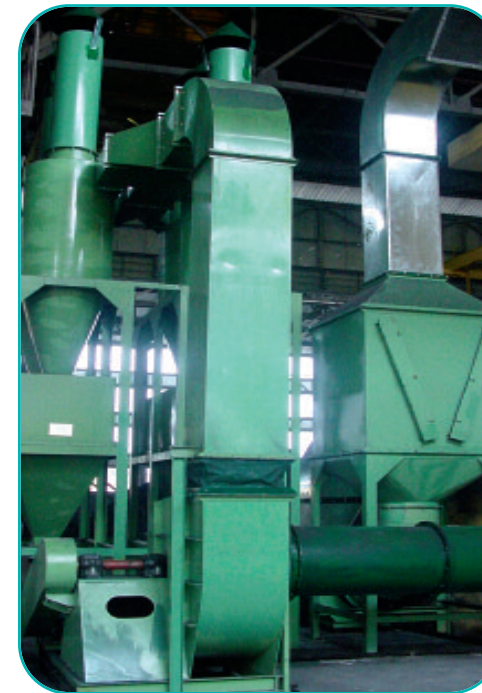
Dự án: Nhà máy nhiệt điện Uông Bí Địa chỉ: TP. Uông bí - Quảng Ninh Công việc: Hệ thống cấp gió - Hệ thống lọc bụi than
