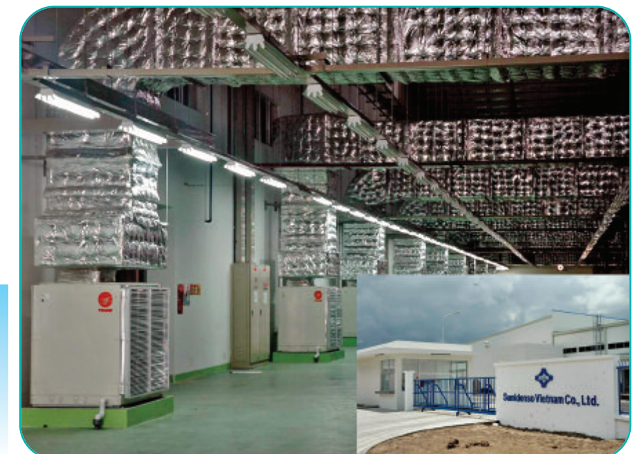
Dự án: SUMIDENSO 3 Địa chỉ: KCN Đại An - Hải Dương Công việc: Hệ thống ống gió ĐHKK
