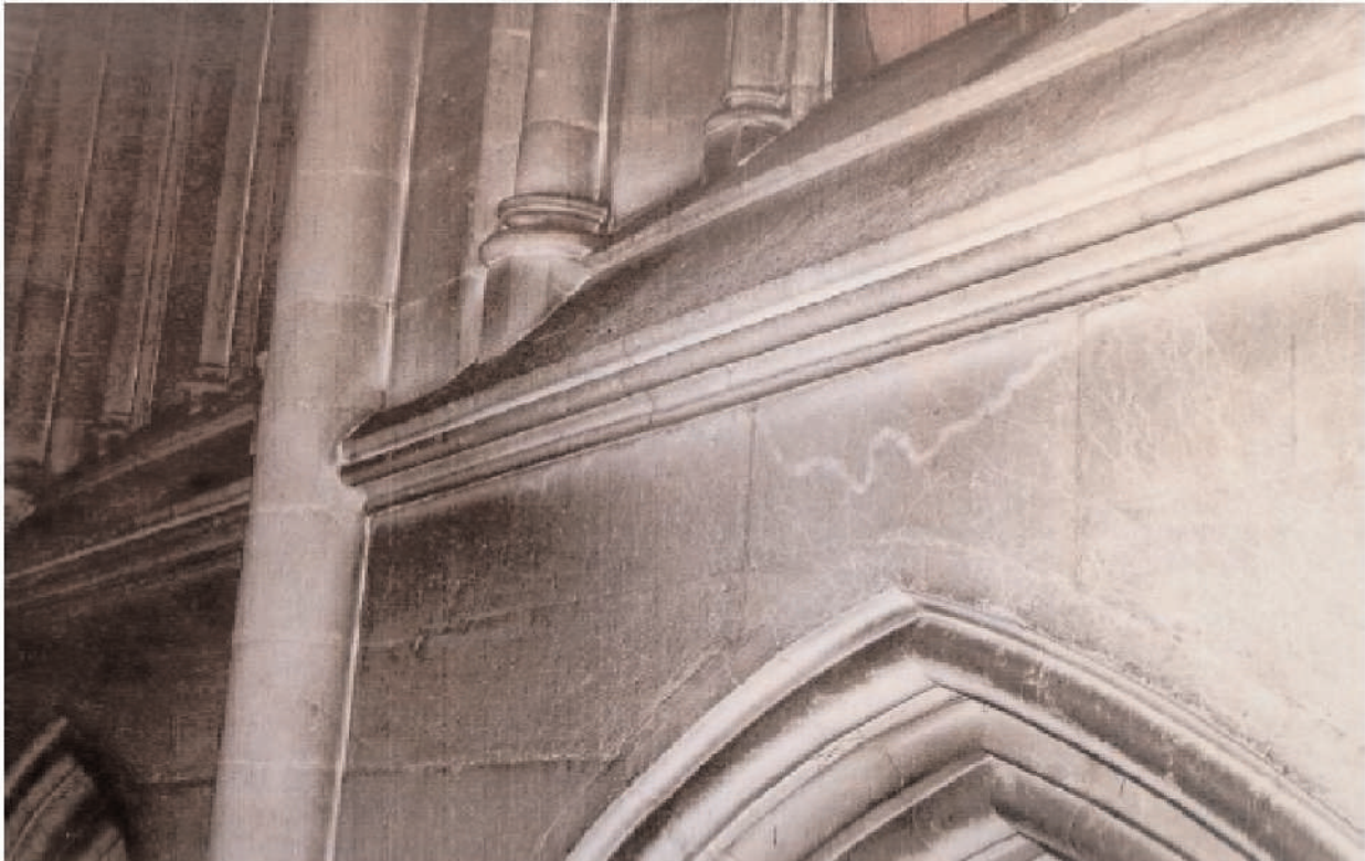
Hình 3: Bụi sẫm màu bám trên bề mặt bên trong gian chính của giáo đường
