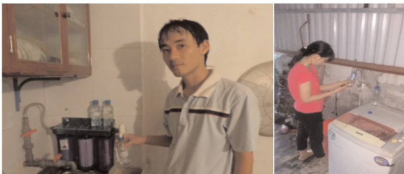
Hình 6: Thiết bị lọc nước lắp đặt tại nhà ông Ngô Bá Hoài (bên trái) và ông Nguyễn Quang Đông (bên phải)
